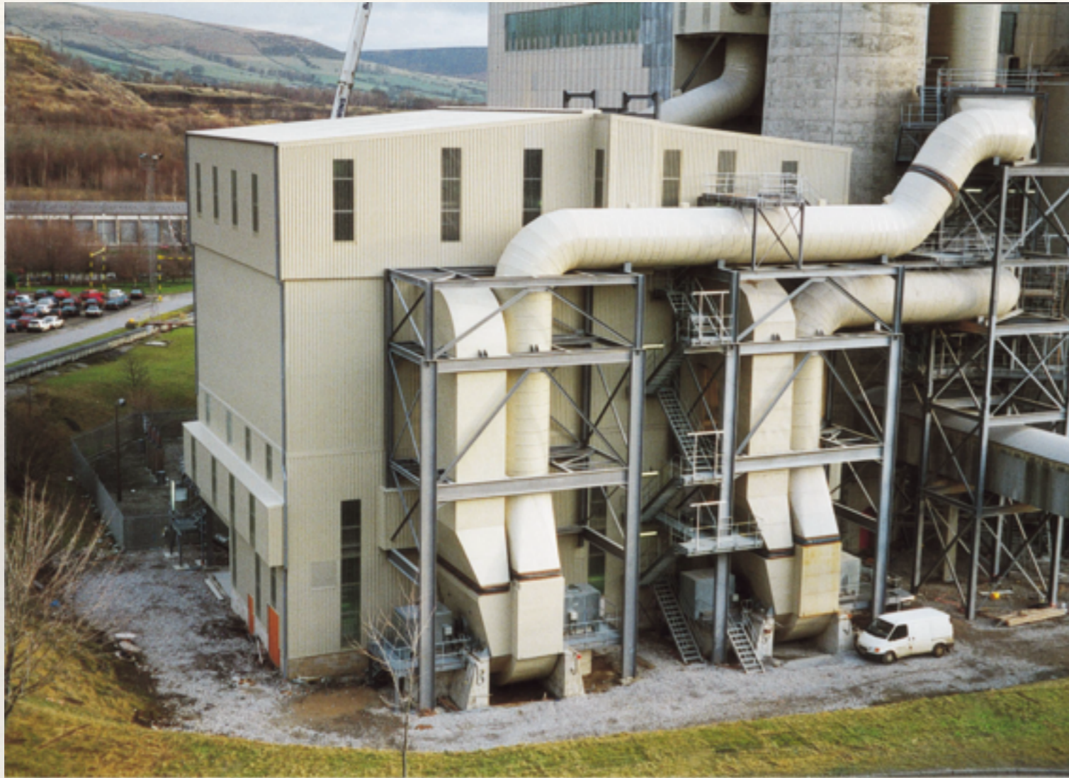
Фильтр цементно-обжигающей печи
